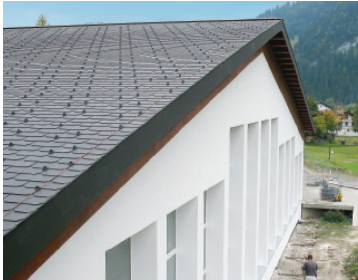
Die Isolation des Dachs über dem Hallenbad wurde von 120 mm auf neu 320 mm erhöht.
