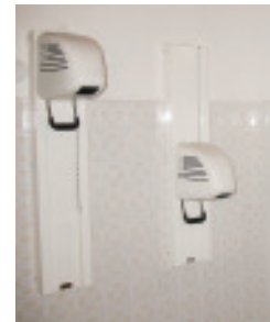
In den Garderoben wurden die Haarföhne ersetzt.
