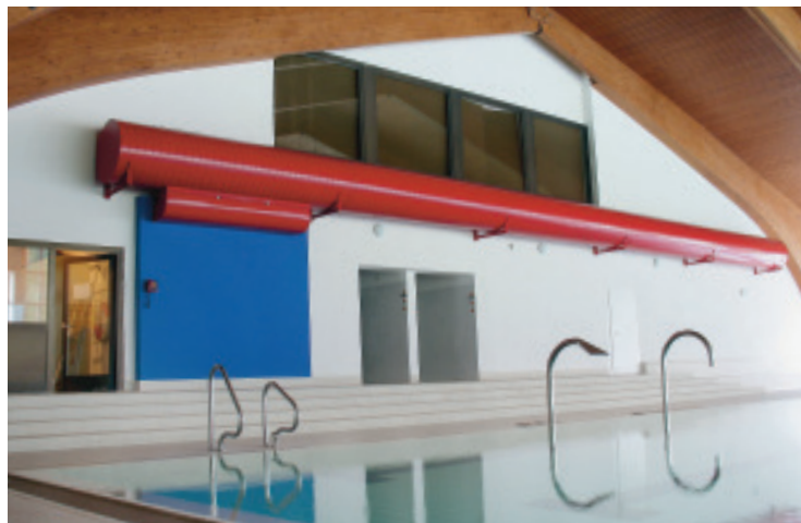
Die Wärmerückgewinnung aus der Abluft senkt den Energieverbrauch. Auf vielfältigen Wunsch wurden zwei Wasserschwallduschen installiert.
