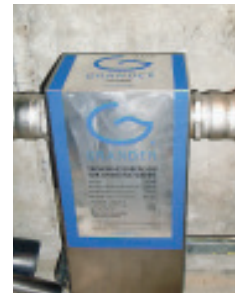
Das System «Grander» zur Belegung des Wassers ergänzt die moderne Wasseraufbereitung.
